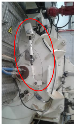
Figura 4.11 - Quebra de fusível.
